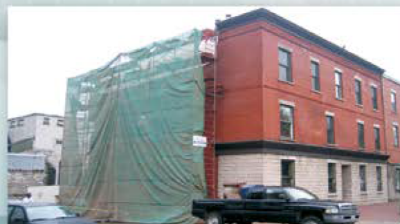
SYNDICAT DES COPROPRIÉTAIRES DU 2030 ST-ANTOINE OUEST Reconstruction des sections des murs de briques avec des ventres de boeuf
